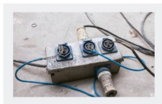
Tomadas e fiação inadequadas
